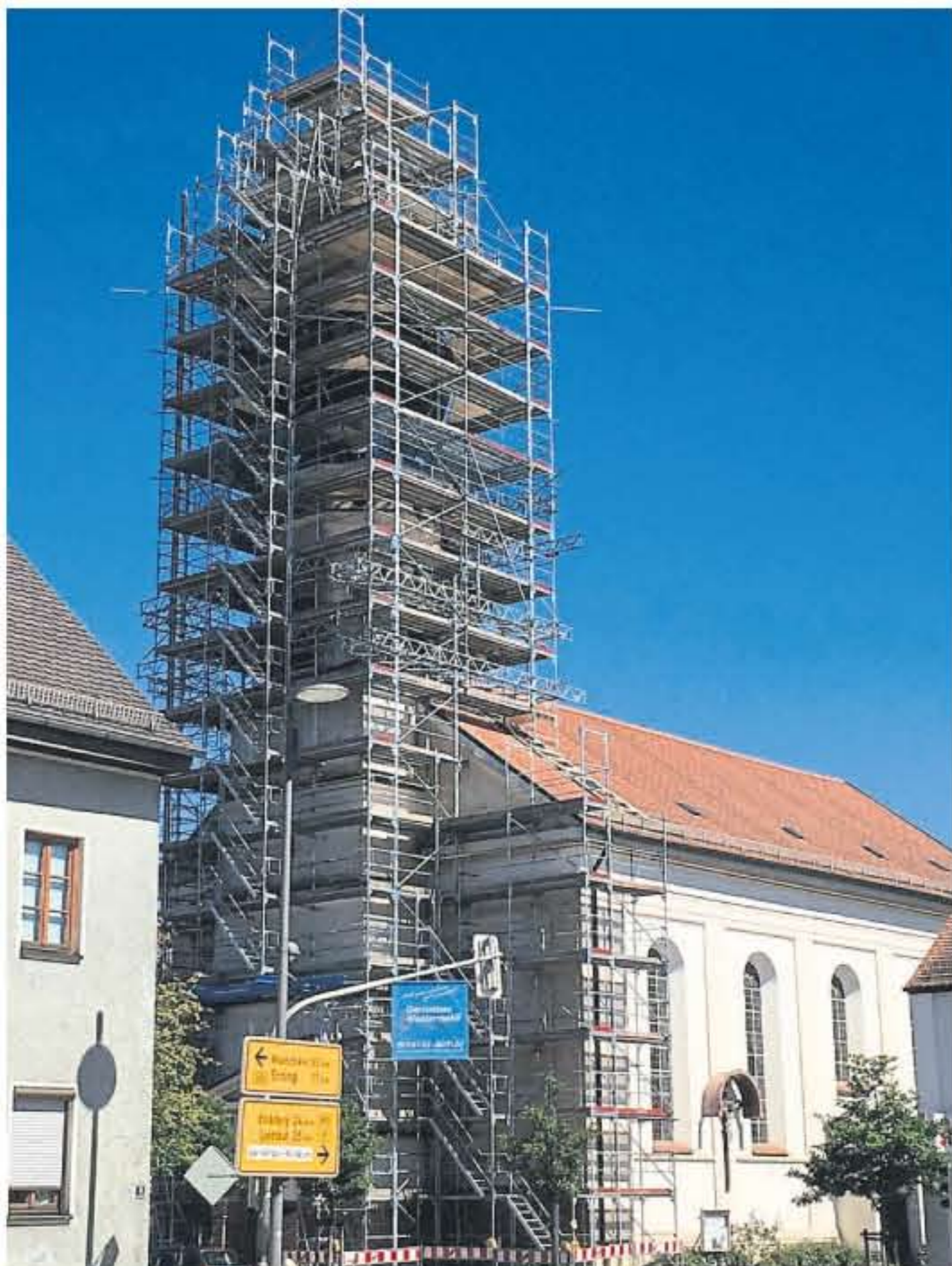
Die Expertise der Firma ist auch bei der Sanierung von Kirchen gefragt – wie hier beim Kirchturm in Taufkirchen/Vils.
